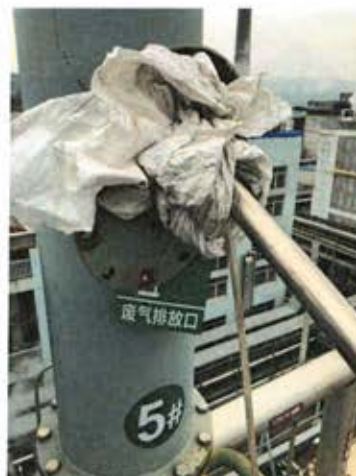
樟脑车间二 脱氢排气筒 5#
