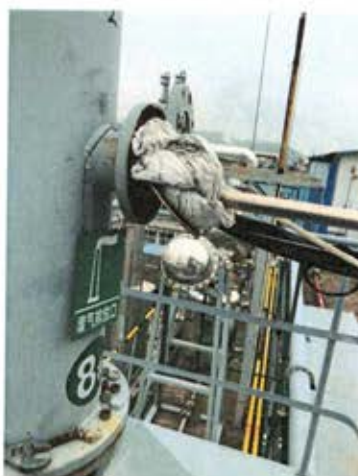
樟脑车间二 升华排气筒 8#
